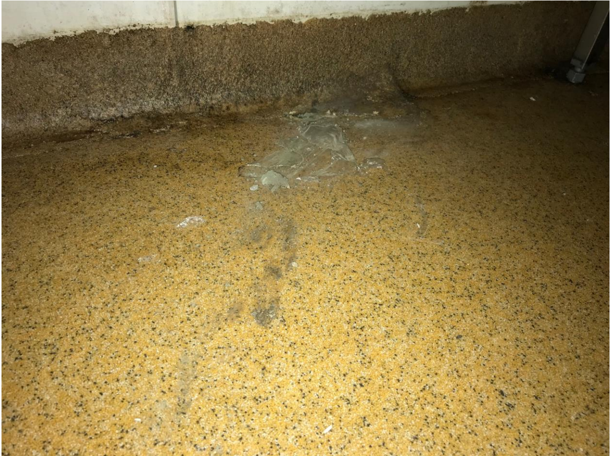
Bild 4. Smuts i torrförrådet.
