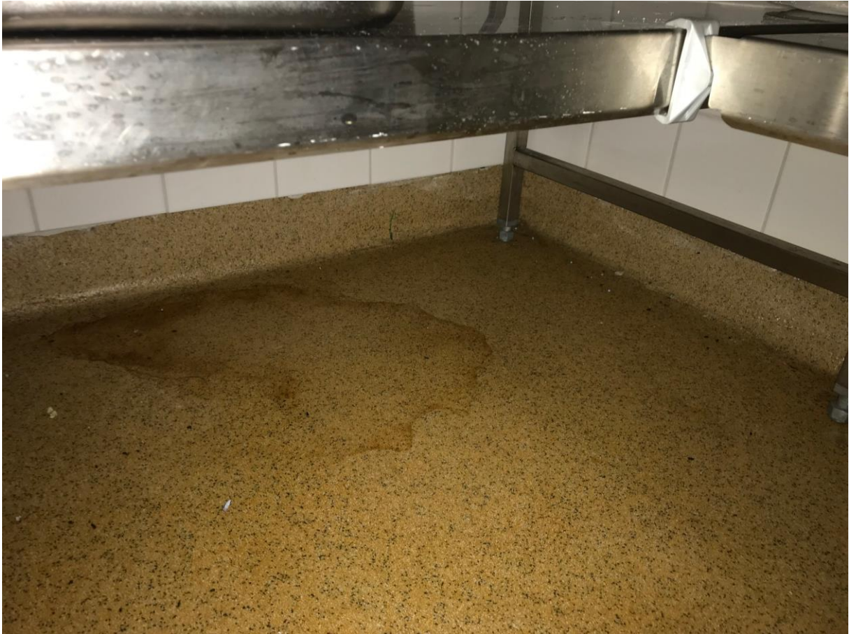
Bild 5. Smuts i torrförrådet.
