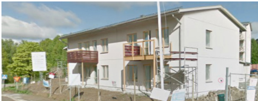
Exempel där elementskarv inte arbetats in som del av fasaduttryck och exempel där det har arbetats in.
