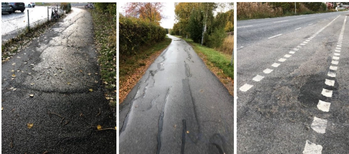
Figur 44-46. Sprickor och uppstickande rötter på gång- och cykelbanan vid Ekebyhovsskolan (vänster). Brister i konstruktionen på en friliggande gång- och cykelväg mellan Gräsåker och Mälaröhallen (mitten). Ojämn beläggning på ett cykelfält vid Brygga industri (höger).
