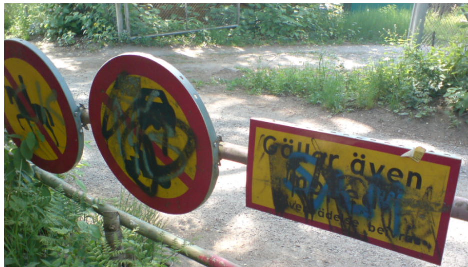
Exempel på vägmärken som behöver bytas ut
