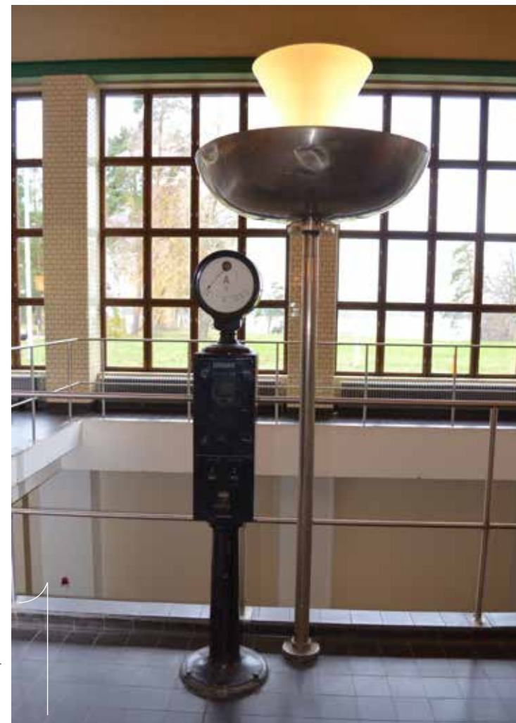
1. Ursprunglig armatur och mätinstrument i maskinhallen på Lovö vattenverk.
