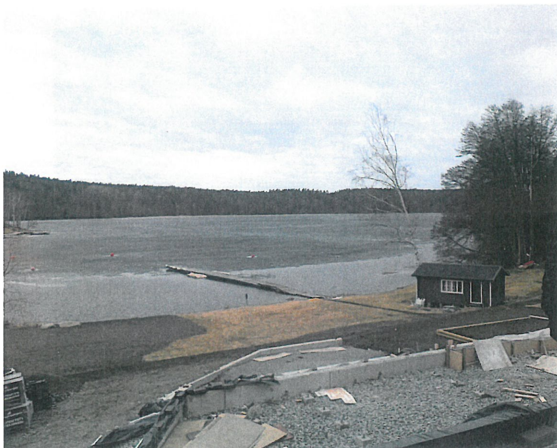
Vy mot Mälaren från Älvnäs 1:266 från samma punkt som i fotot ovan. Älvnäs 1:73 utanför bilden mot vänster.
