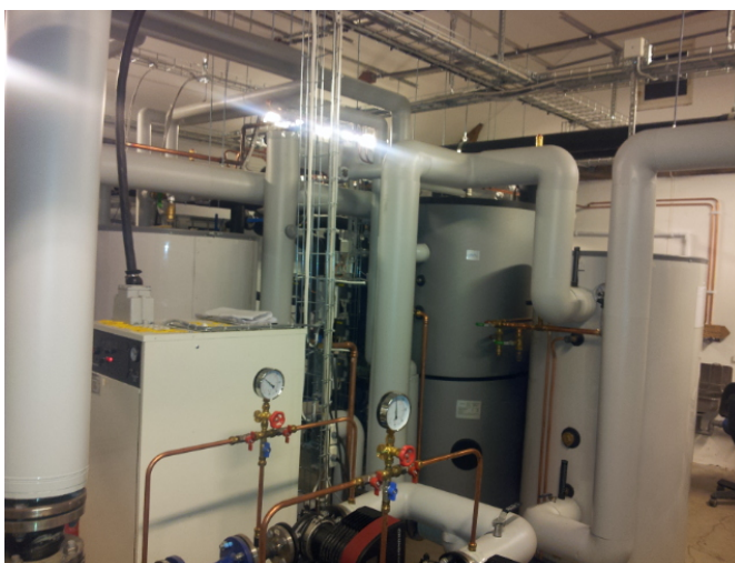
Skå skola - ny bergvärmeanläggning
